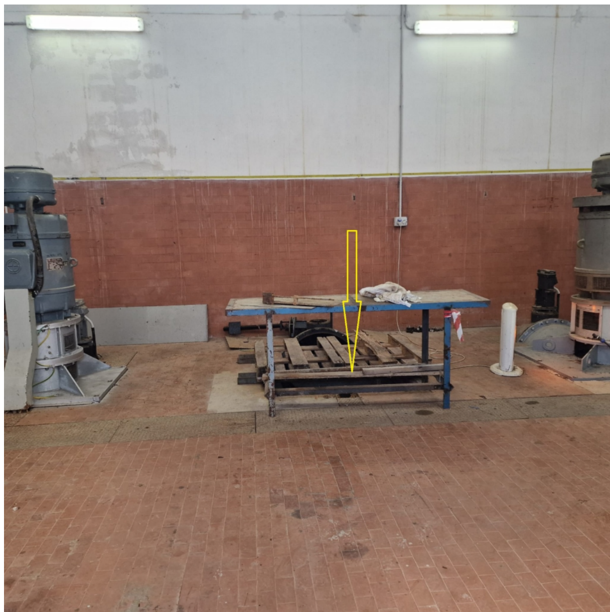
Foto 2) Punto di installazione gruppo pompa
